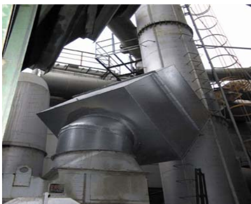
ユニットサイレンサー外観
