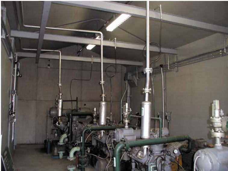
天然ガス圧縮機室防音（天井・壁にカルム使用、効果-25dB）
