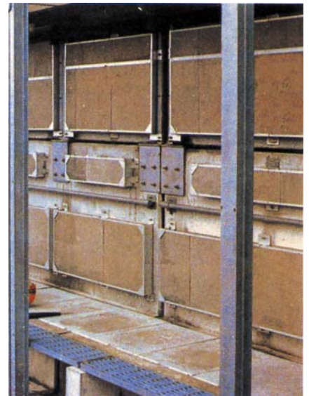
新幹線用逆L型防音壁
