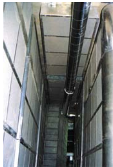
消音設備への使用例
