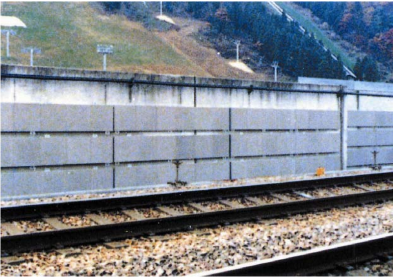
新幹線用防音壁
