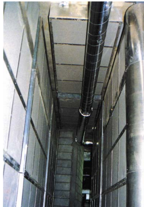
地下歩道換気消音設備
